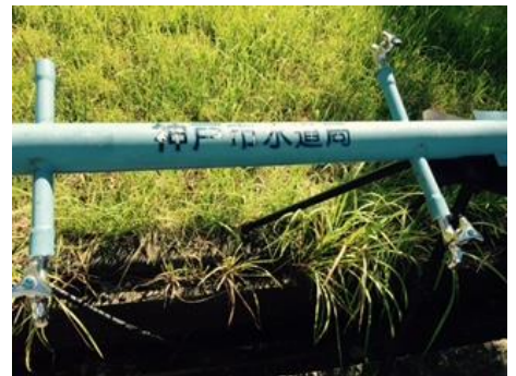
仮設トイレの水道管
