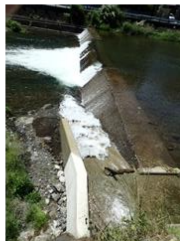
△ 生野高校横の市川に設置されているオオサンショウウオのためのスロープ
